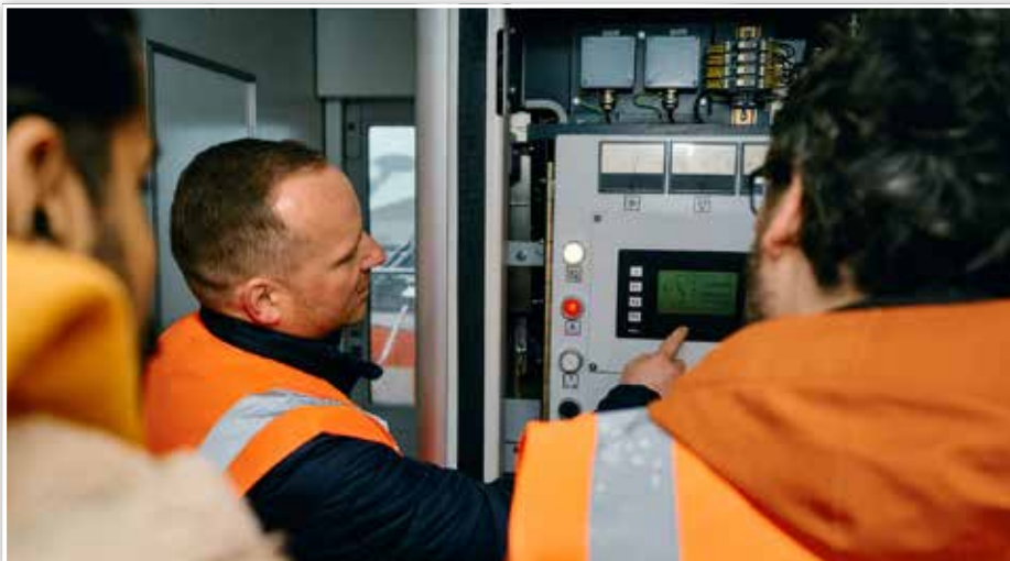
Trainer Tobias Bredow erläutert die einzelnen Bestandteile der Schaltschranktafel.
